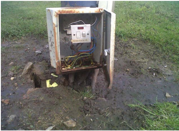
Rys. 2. Zniszczona szafka metalowa eksploatowana w trudnym środowisku
